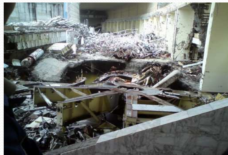
Машинный зал после аварии
